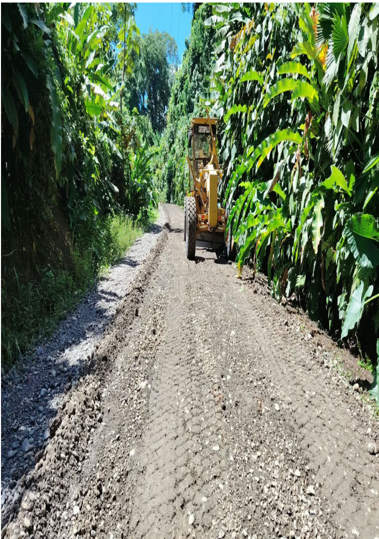
MAQUINARIA EN CAMPO
