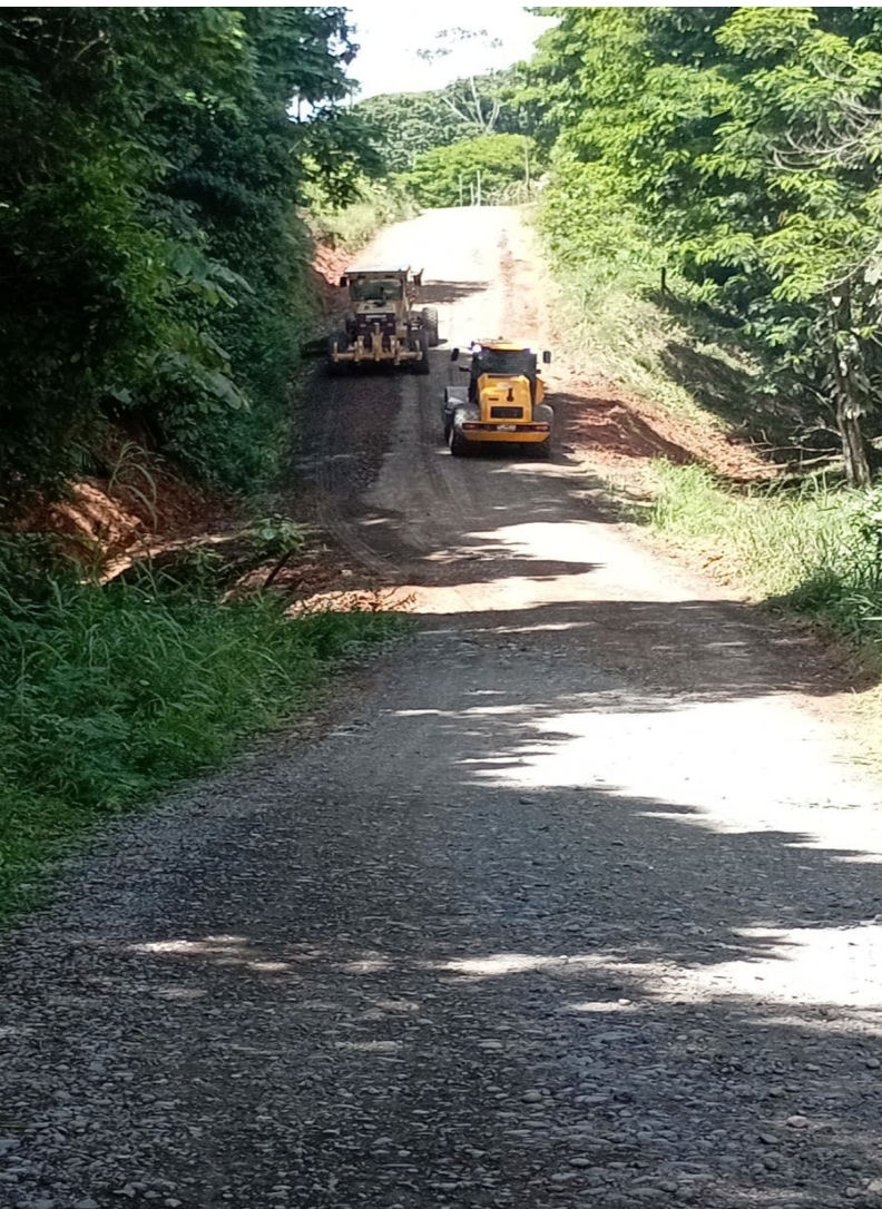
MAQUINARIA EN CAMPO
